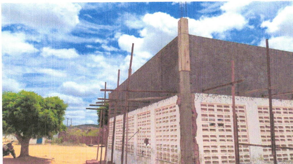
FOTO 12- (COMPOSIÇÃO REPRESENTATIVA) EXECUÇÃO DE ESTRUTURAS DE CONCRETO ARMADO, PARA EDIFICAÇÃO HABITACIONAL UNIFAMILIAR TÉRREA (CASA EM EMPREENDIMENTOS) FCK=25MPA. AF_01_01/2017
