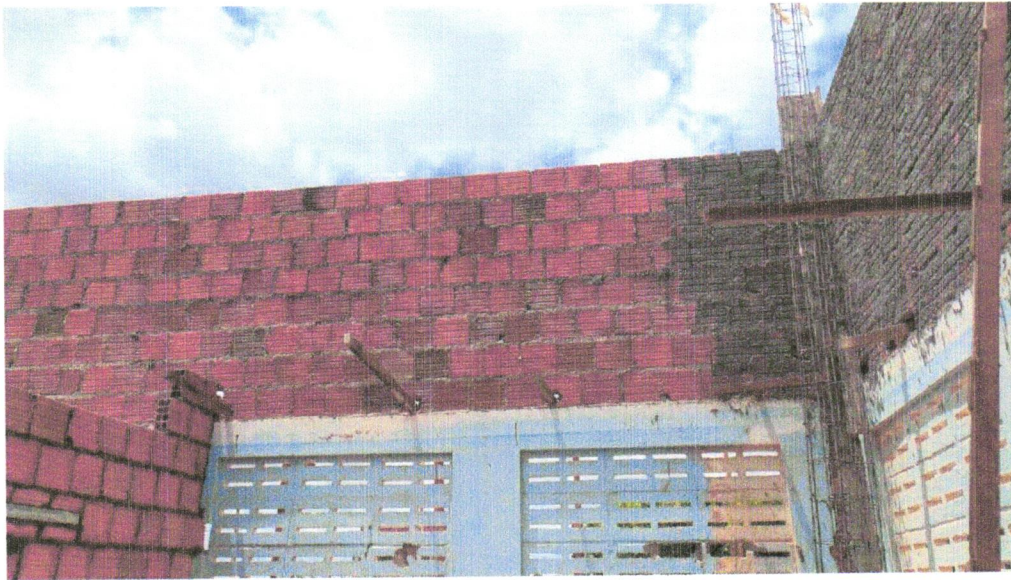
FOTO 05 – ALVENARIA DE VEDAÇÃO DE BLOCOS CERÂMICOS FURADOS NA HORIZONTAL DE 9X19X29 CM (ESPESSURA 9 CM) E ARGAMASSA DE ASSENTAMENTO COM PREPARO EM BETONEIRA. AF_12/2021
